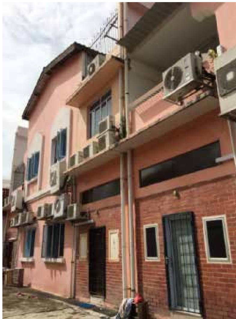
Des unités extérieures de climatiseurs installées de manière chaotique sur une façade. (Source : FNCCR).
