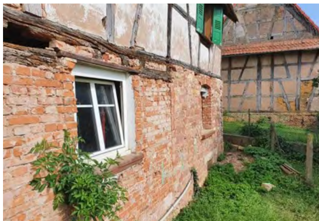
Le mur gouttereau dans l'état initial, la maçonnerie en débord de 10 cm a causé le pourrissement de la sablière et nécessité son remplacement.
